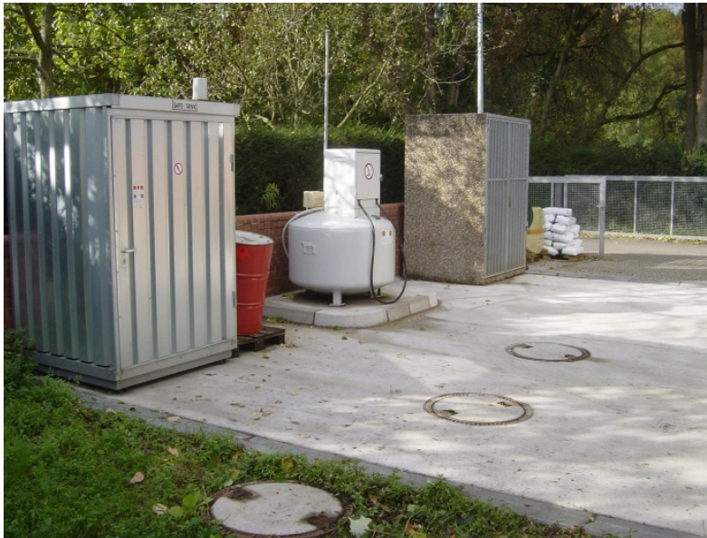
Abb. 5: Waschplatz mit Betankungs- und Abscheideranlage an der Gärtnerei
